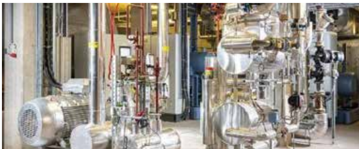
Abb. 34: Hochtemperaturwärmepumpe Ennstal Milch
